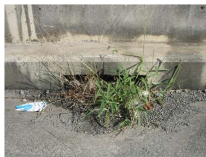
排水ますの土砂詰り
