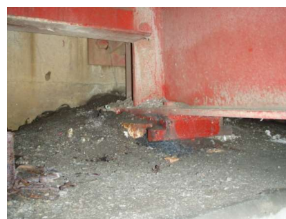
橋の端部の土砂堆積
