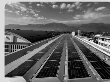
竜王中学校 (太陽光発電設備)
