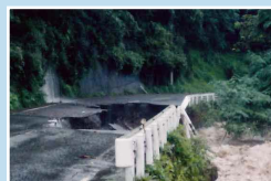
平成 12 年 9 月 獅子平地内 (道路陥没)
