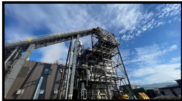
【ボイラー】外観
