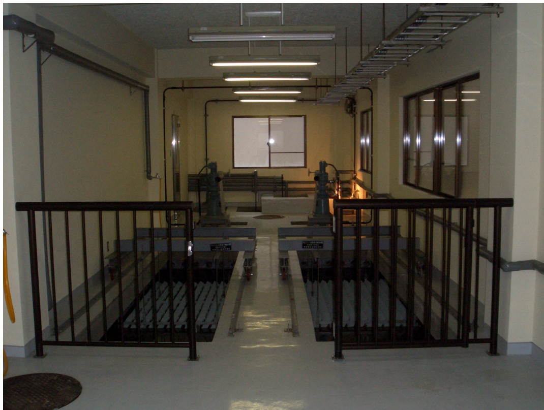
清川簡易水道(浄水場内 浄水処理室)
