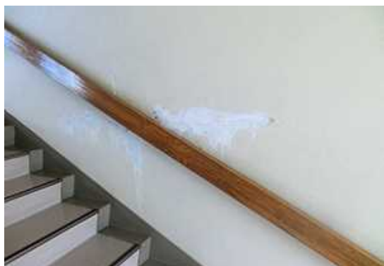
階段室の漏水跡（竜王南小学校 B 棟）
