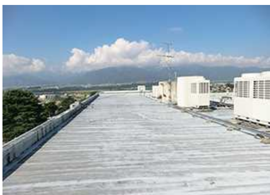
シート防水の劣化（双葉中学校 A 棟）
