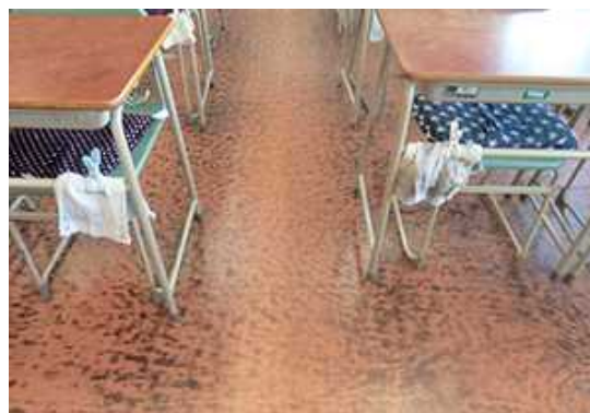
床材の劣化（敷島中学校 B 棟）
