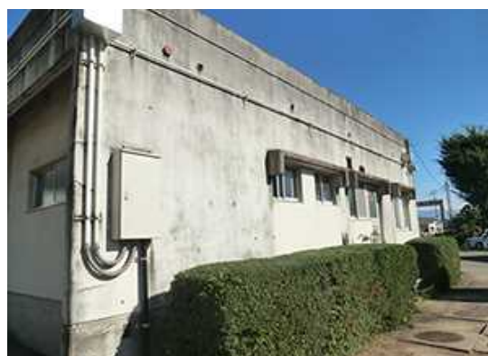
外壁の劣化（敷島北小学校 B 棟）
