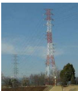
送電線と鉄塔
