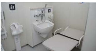
オストメイト対応のだれでもトイレ(新館1階3階、本館1階)
