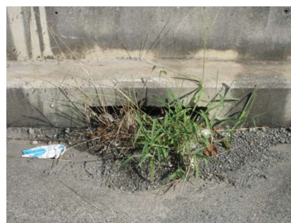
排水ますの土砂詰り
