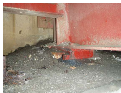
橋の端部の土砂堆積
