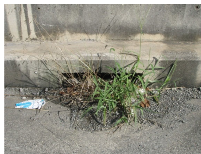
排水ますの土砂詰り
