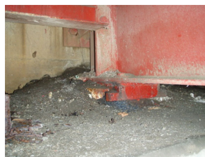
橋の端部の土砂堆積
